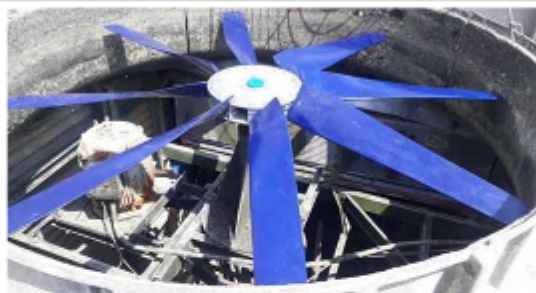
MOC : FRP fan blades
